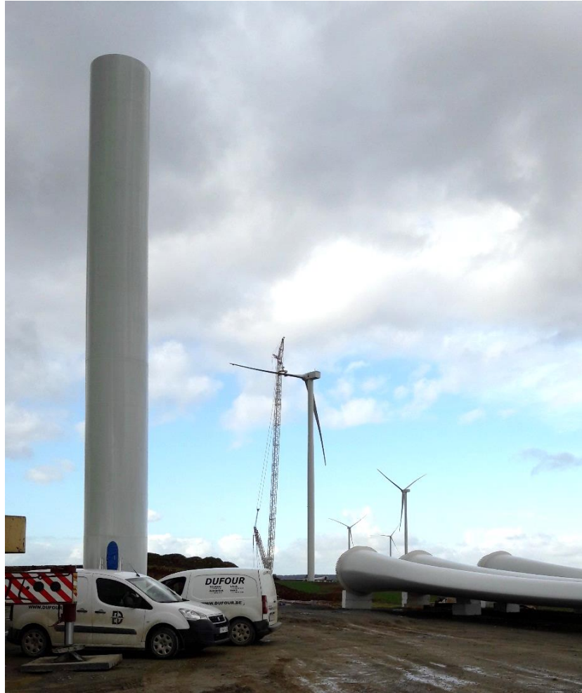
Parc éolien de Champagne-Berrichonne, Indre
